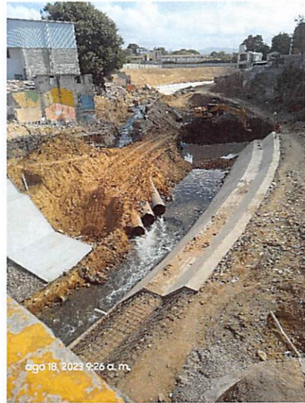
Desvio de agua en canal.
