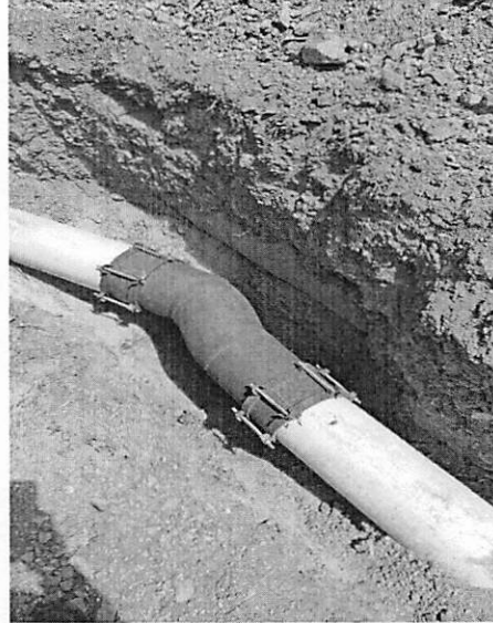
FOTO 2. Codo de Acero con Junta Dresser en Tubería de Ø12" PVC SDR-26
